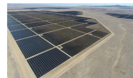
Ferme solaire Solar Farm
